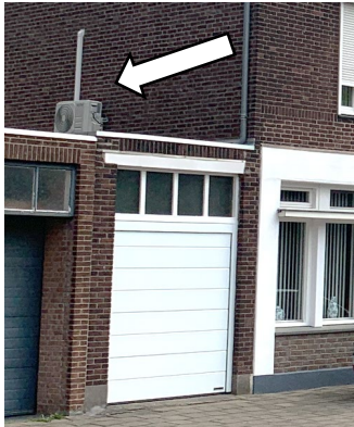
Foto van een buitenunit bevestigd aan een woning
